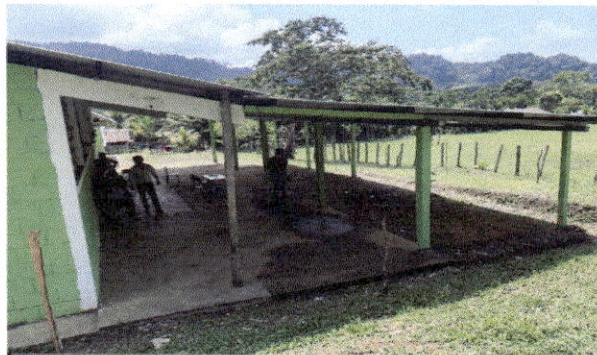
Foto 4: estructura de lamina en mal estado
