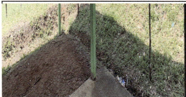
Foto 3: columna en mal estado y sobrepuesta.
