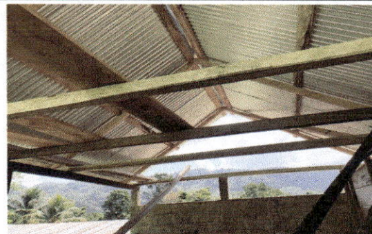
Foto 2: Vigas de madera no adecuadas.
