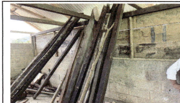
Foto 5: Vigas de madera destruidas.
